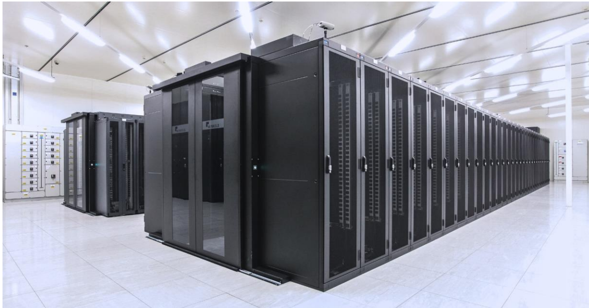
A data center
